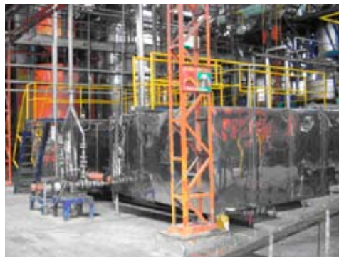
Foto 8. Aceites S.A. Preclarificadores
