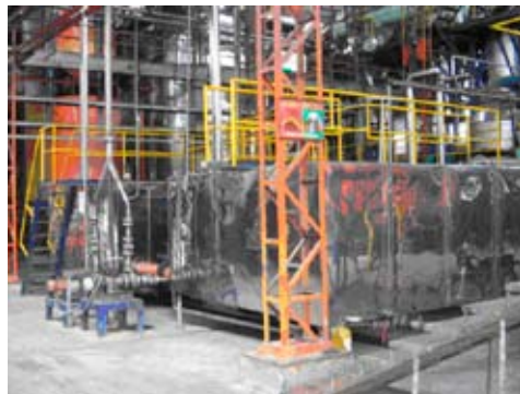
Foto 8. Aceites S.A. Preclarificadores
