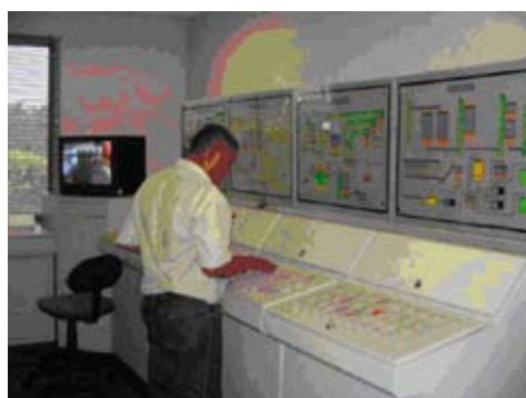
Foto 11. Aceites S.A. Cuarto de control
