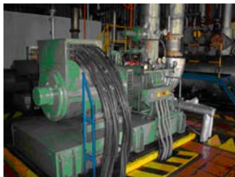
Foto 9. Palmeras de la Costa S.A. Turbinas
